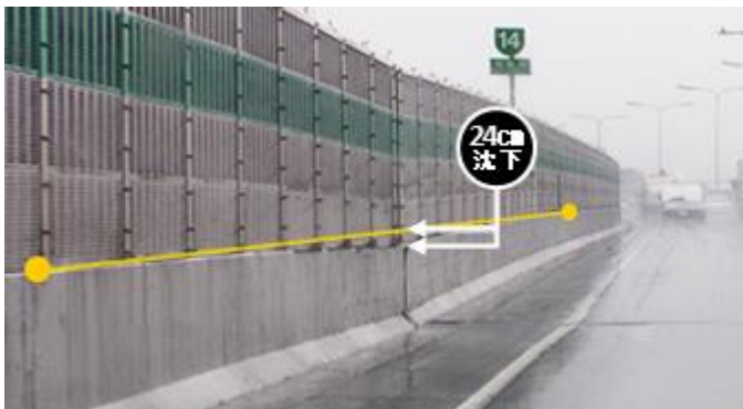
橋桁中央部の沈下状況
